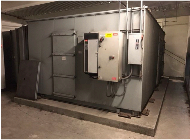
25 – GARAGE EXHAUST FAN UNIT
